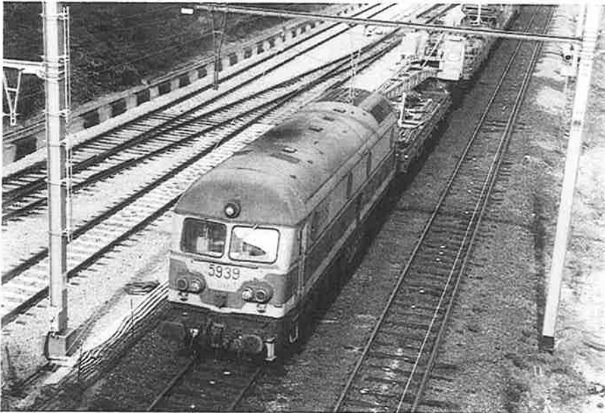
Leuven, 2 oktober 2000. HLD 5939 aan de kop van een werk- of baantrein tijdens het wegnemen van de bovenleiding op de oude hoofdsporen naar Tienen, bij het buitenrijden van Leuven. Foto : Alain Janmart.
